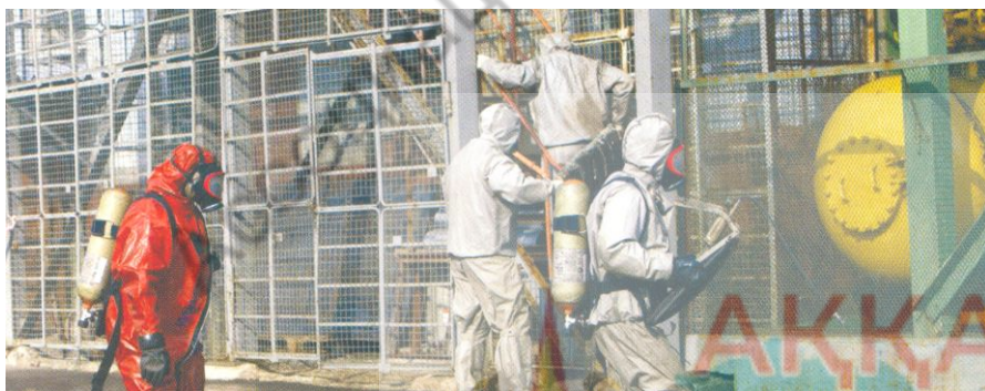
Рис.215. Проведение аварийных газоспасательных работ
